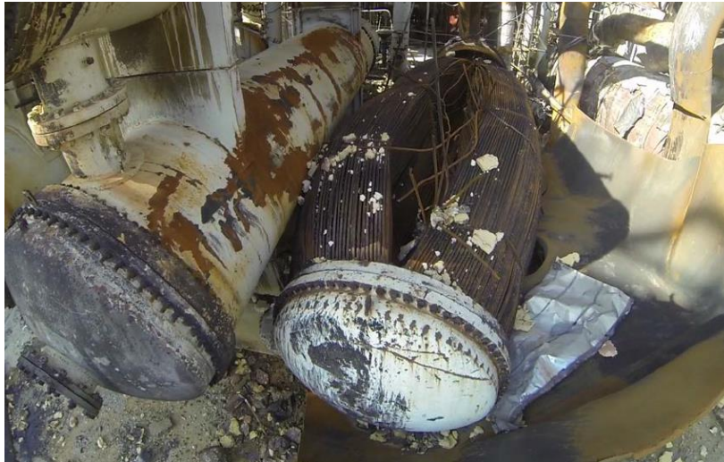
Slika 11. Izmjenjivač topline B na kojem je došlo do eksplozije [4]
