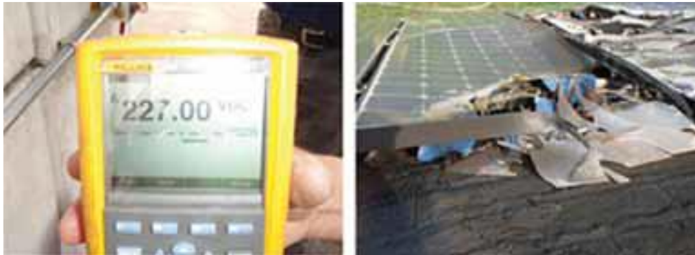
Slika 15. Napon fotonaponskog panela nakon oštećenja [9]
