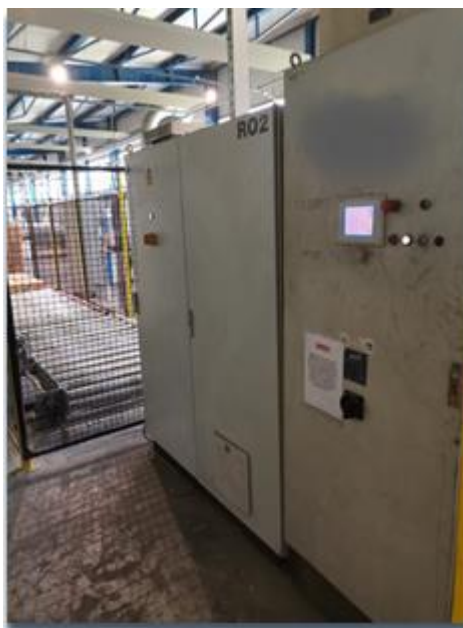
slika 12.prikaz električnog ormara (izvor:osobna arhiva autora)
