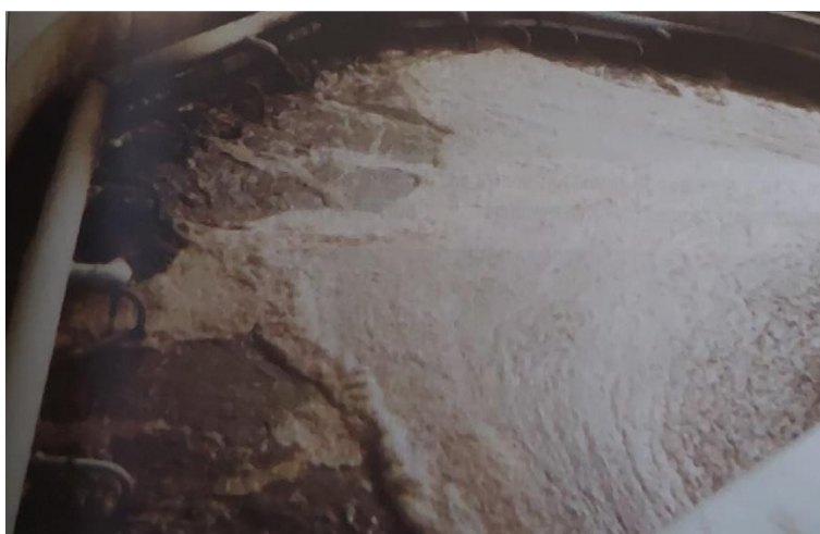
Slika 10. Aerobna stabilizacija mulja na uređaju za pročišćavanje [8]
