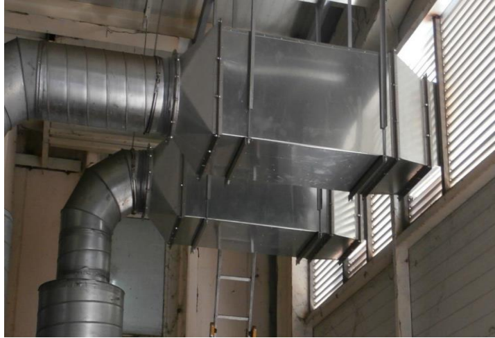
Slika 7. Prigušivači buke u ventilacijskom sustavu
