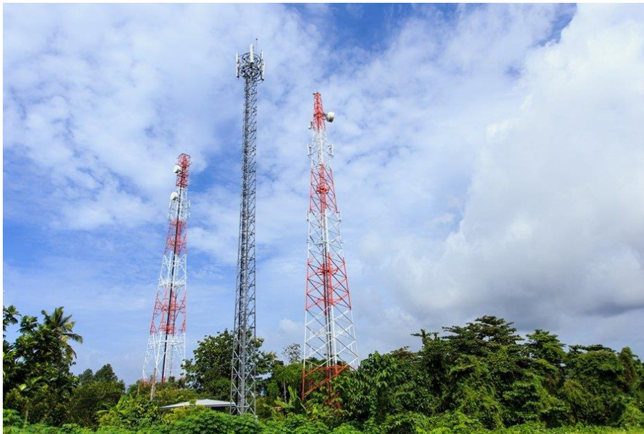
Slika 1. Samostojeći antenski stupovi
