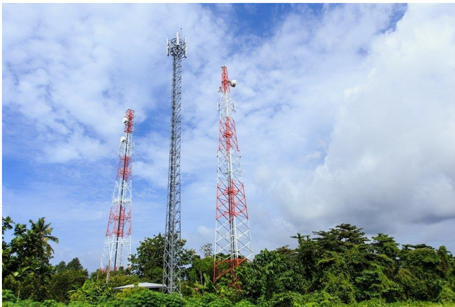
Slika 1. Samostojeći antenski stupovi
