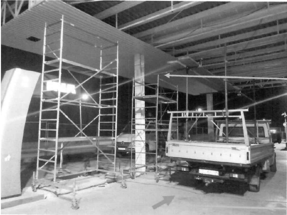
Slika 7 Incident na benzinskoj postaji [11]
