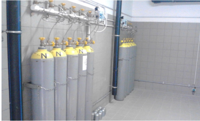
Slika 9. Skladištenje plinskog klora
