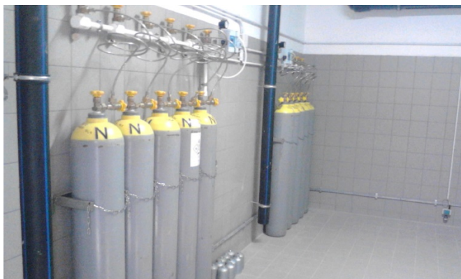
Slika 9. Skladištenje plinskog klora
