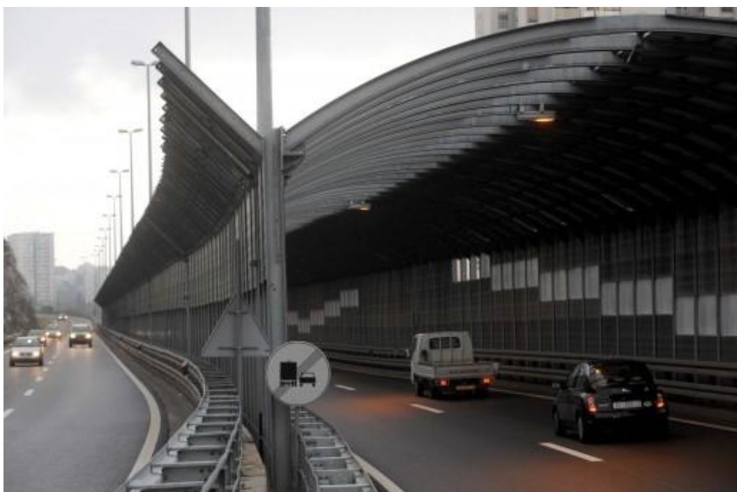
Slika 24 Solarna elektrana na riječkoj obilaznici ujedno i zid za zaštitu od buke
