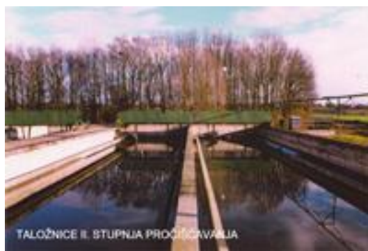
Slika 11. Taložnice II.stupnja pročišćavanja [17]
