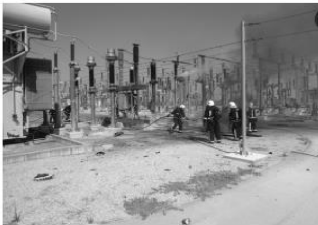
Slika 5. Požarište na visokonaponskom postrojenju TS 110/10710 kV Dubovac [7]
