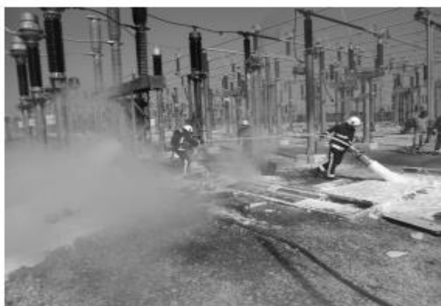
Slika 6. Gašenje požara energetskih kabela na TS 110/10/10 kV Dubovac pjenom [7]
