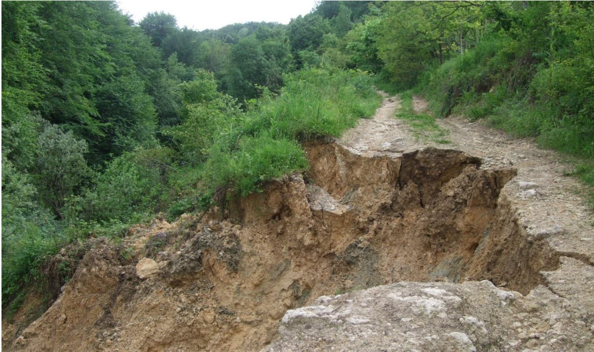
Slika 8. Prikaz djelovanja erozije na tlo.
