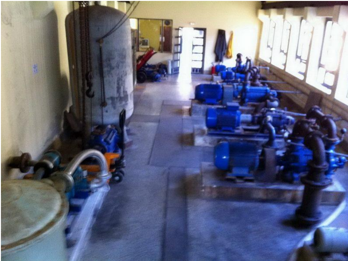
Slika 2: Crpna stanica iznutra
