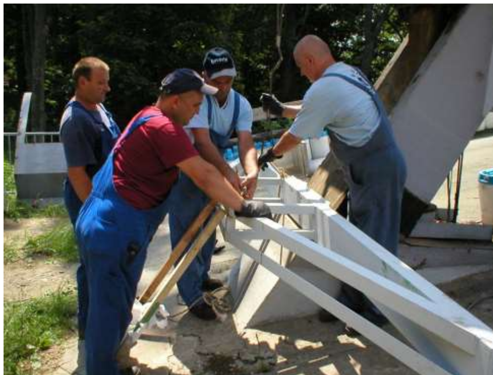
Slika 24 Naprava za preuzimanje nosivog užeta
