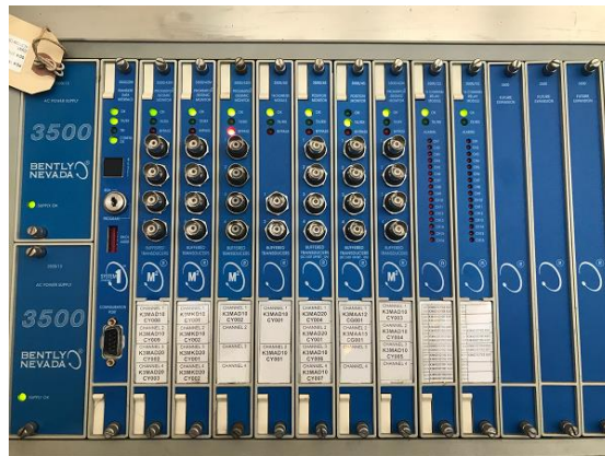
Slika 44. "Bently Nevada" 3500 - sustav zaštite strojeva od vibracija ; Izvorno autor
