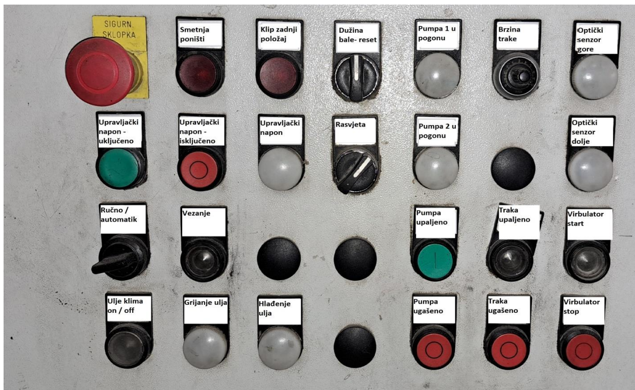
Slika 16. Vanjski dio upravljačkog ormara
