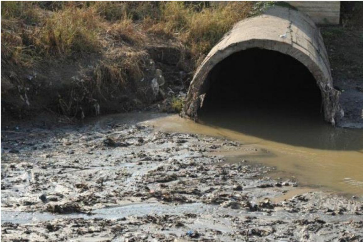
Slika 2. Prikaz neadekvatnog zbrinjavanja otpadnih voda
