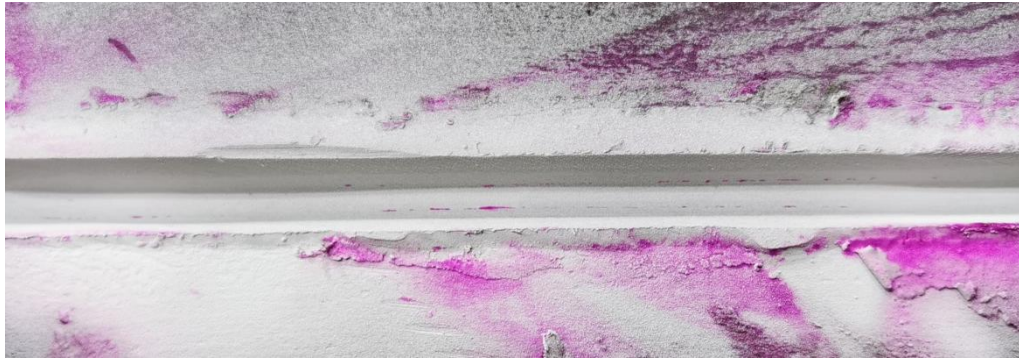
Slika 61. Neprihvatljive indikacije na zavarenom spoju „ojačanja“ i „kocke“
