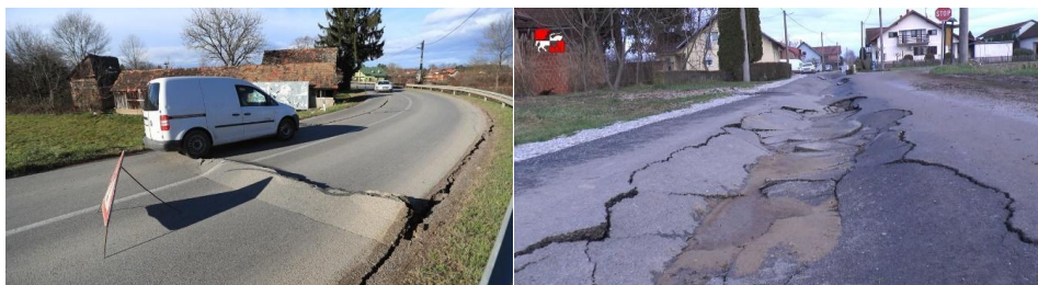
Slika 4. Primjeri oštećenja prometnica [5]
