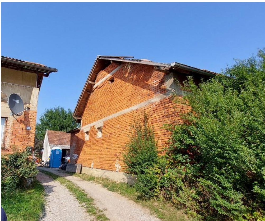
Slika 36. Nagnuti zabatni zid kuće [17]
