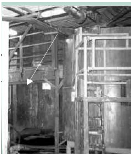
Slika 13: WWT pročišćivač otpadnih voda [12].
