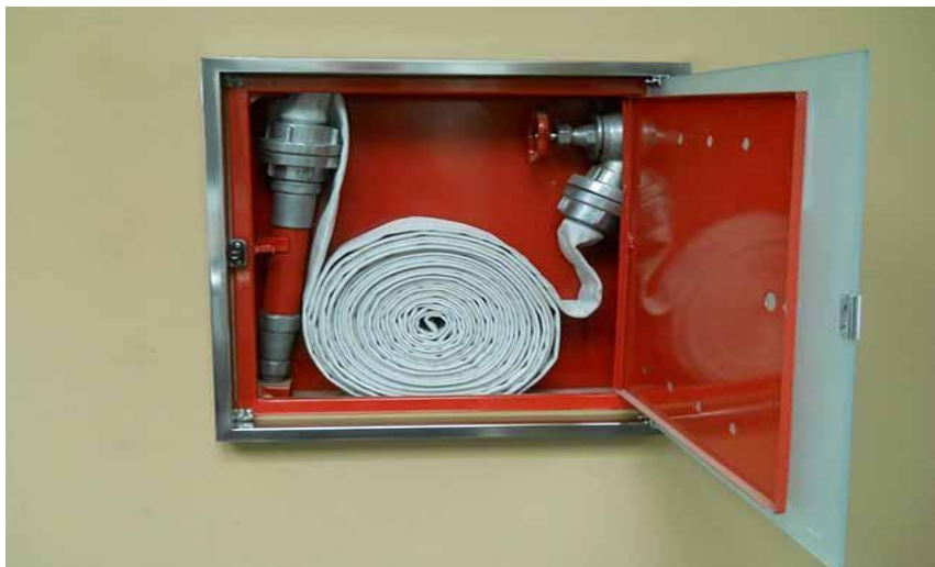
Slika 13. Izvedba zidnih hidranata i ormarića[16]
