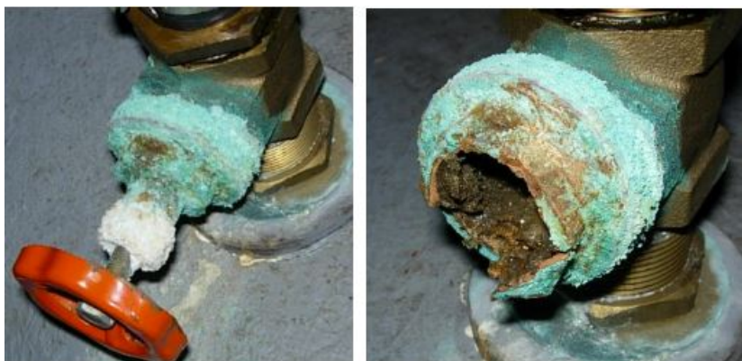
Slika 18. Puknuće ventila uslijed decinkacije mjedi ( http://www.oceanmarinesurveys.co.uk/through-hull-fittings/ , Pristupljeno 20.12.2022.)
