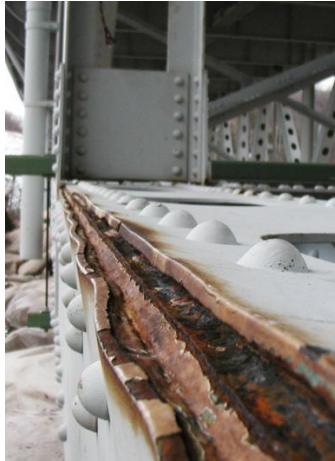
Slika 17. Korozija u procijepu između dva jednaka metala na konstrukciji mosta ( http://www.termarust.com/resources/tp1.php , Pristupljeno 20.12.2022.)
