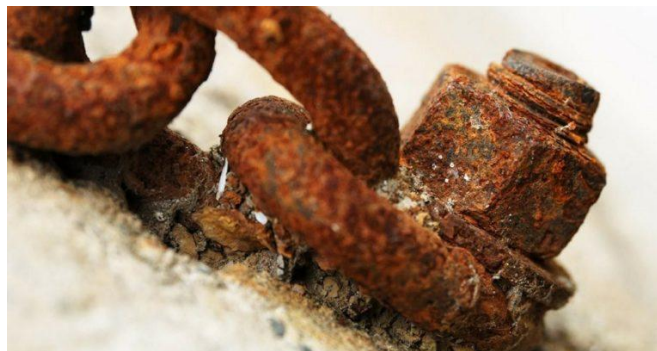
Slika 4. Korozija ( https://www.gradnja.me/clanak/8/Za%C5%A1tita-%C4%8Deli%C4%8Dnih-konstrukcija-od-korozije , Pristupljeno 9.1.2023.)
