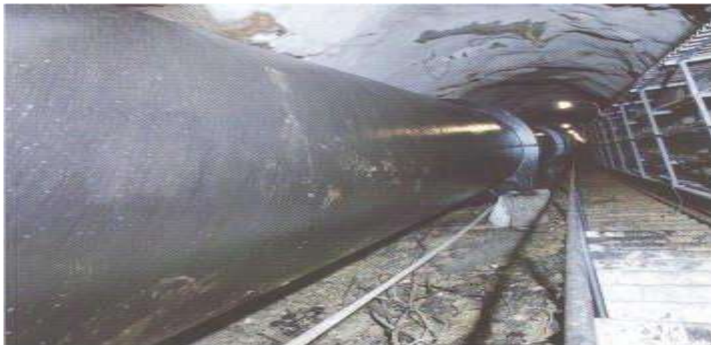
Slika 3. Tlačni cjevovod na Hidroelektrani Rijeka [2]
