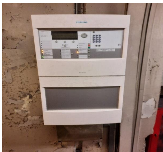
Slika 9. Vatrodojavna centrala smještena u pješačkom prolazu (vlastiti izvor)
