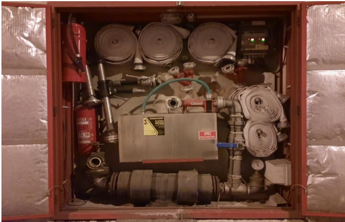
Slika 7. Hidrantski ormar u lijevoj cijevi tunela Mala Kapela (vlastiti izvor)
