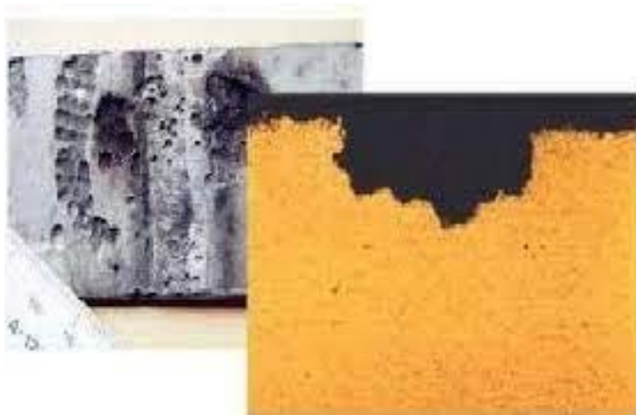
Slika 13. Detalj primjer pjegaste korozije [17]
