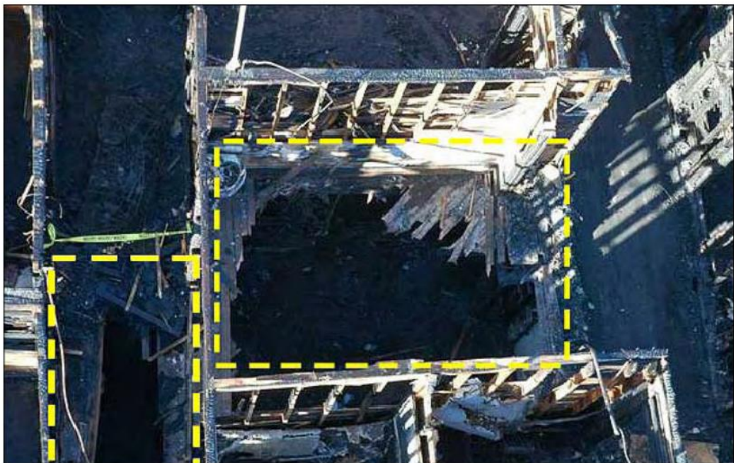
Slika 12. Urušeni dijelovi krova na trećem katu sjevernog krila [6]
