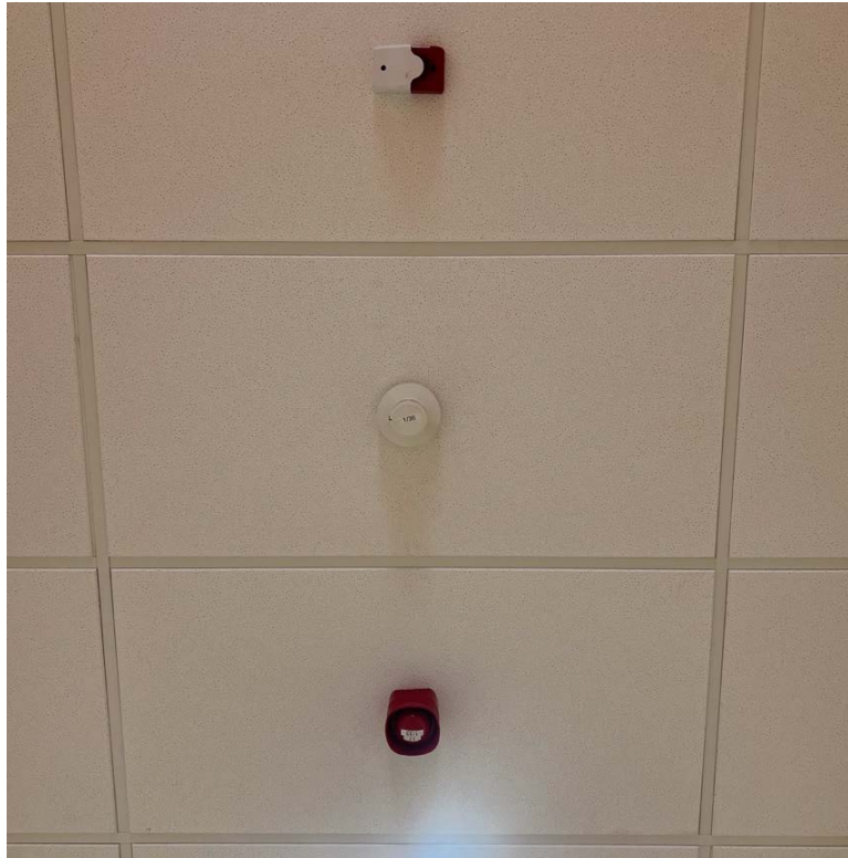
Slika 16. Svjetlosni signal, detektor dima i sirena na stropu Dječjeg vrtića Rakovac, vlastiti izvor autora
