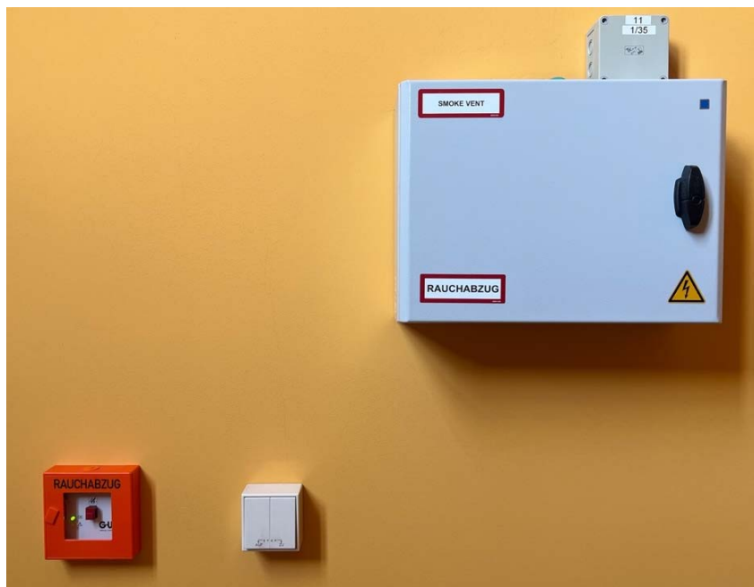
Slika 15. Centrala za upravljanje otvaranja prozora za odimljavanje stubišta, vlastiti izvor autora
