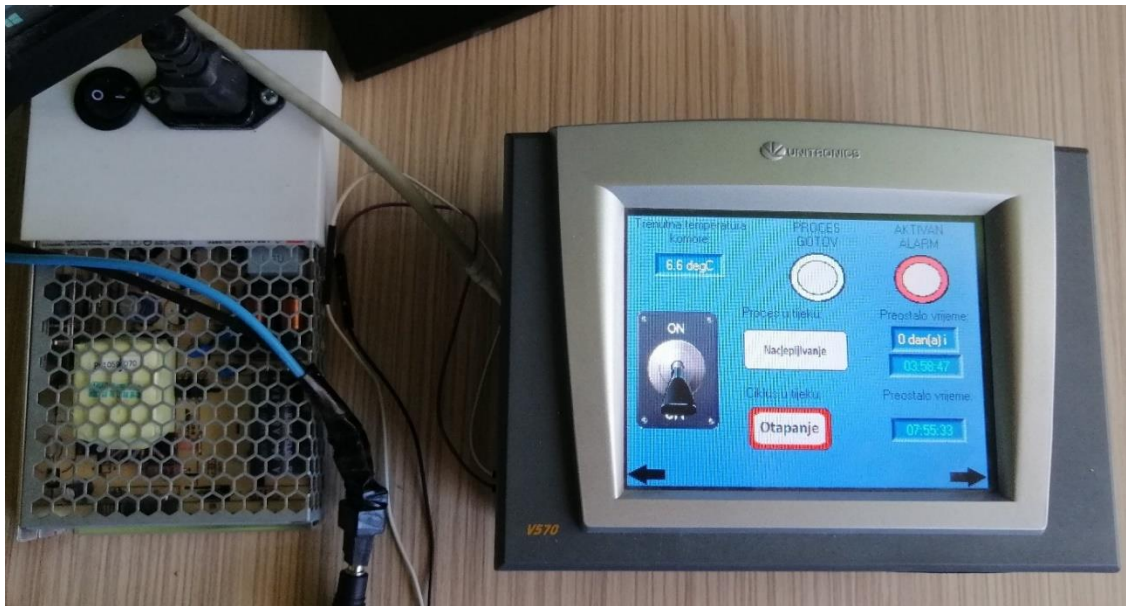
Slika 17: PLC (desno) i napajanje (lijevo)
