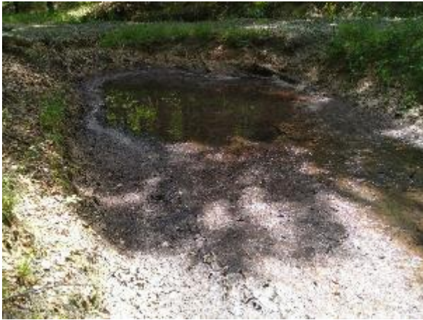
Slika 49. Cesta s vrlo malim propustom zadržava lišće
