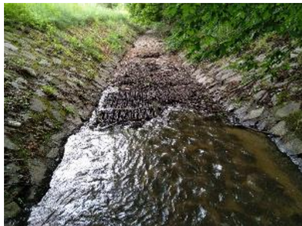
Slika 2. Usisnica akumulacije Novo Zvečevo
