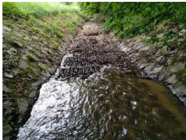
Slika 2. Usisnica akumulacije Novo Zvečevo
