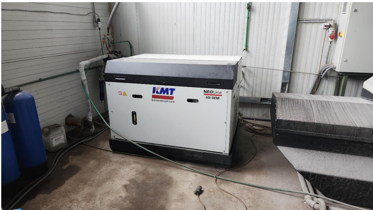
Slika 35. Kućište sustava niskog i visokog tlaka vode
