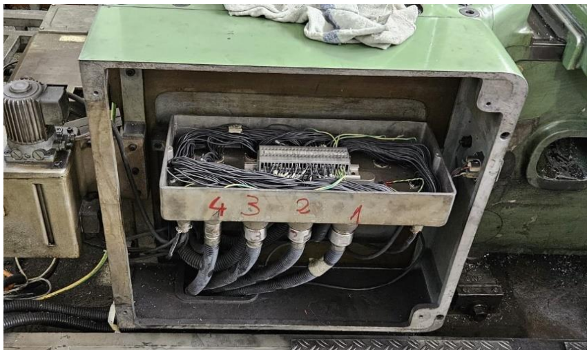
Slika 23. Potreban poklopac instalacija[Autor]
