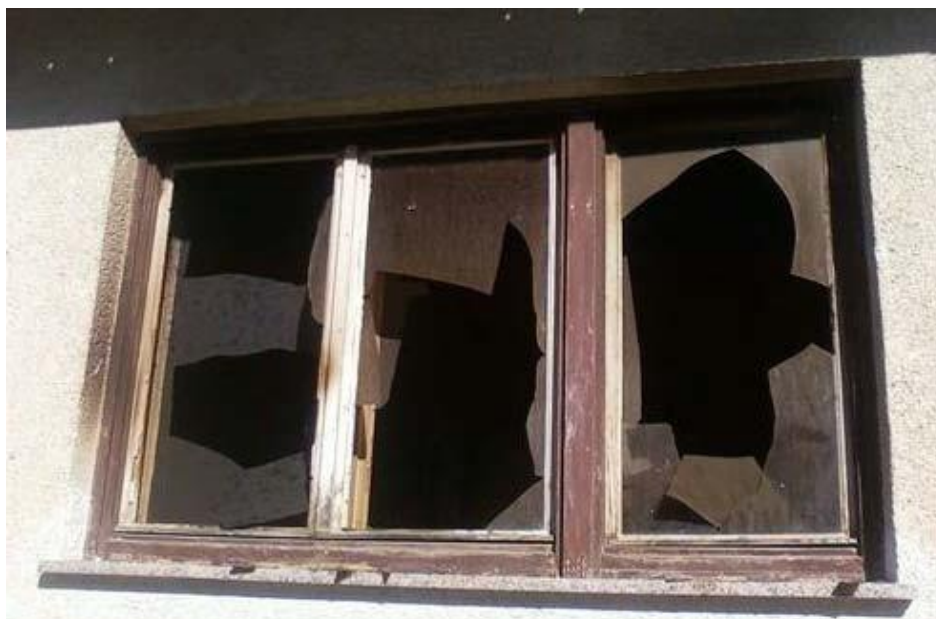
Slika 12. Tragovi gareži na staklu [9]
