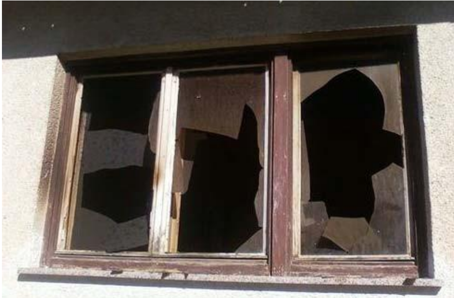
Slika 12. Tragovi gareži na staklu [9]
