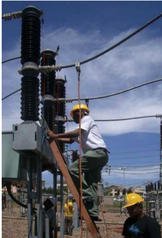
Slika 28. Ispitivanje prekidača uzemljenja [21]
