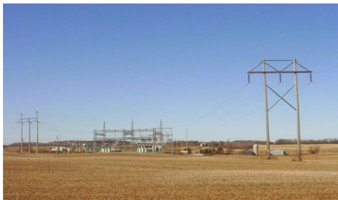
Slika 17. Trafostanica u poljoprivrednom polju [38]
