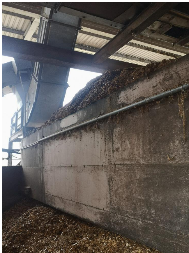
Slika 29. Termički javljač u dnevnom spremniku sječke [5]
