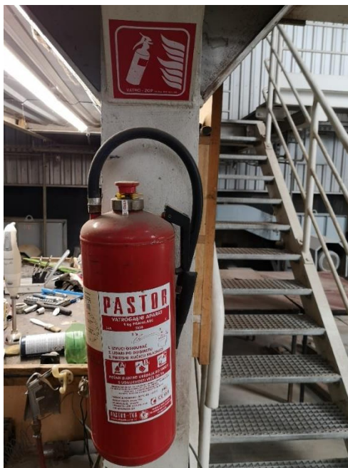
Slika 17. Vatrogasni aparat unutar postrojenja [5]
