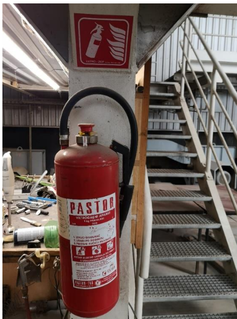
Slika 17. Vatrogasni aparat unutar postrojenja [5]
