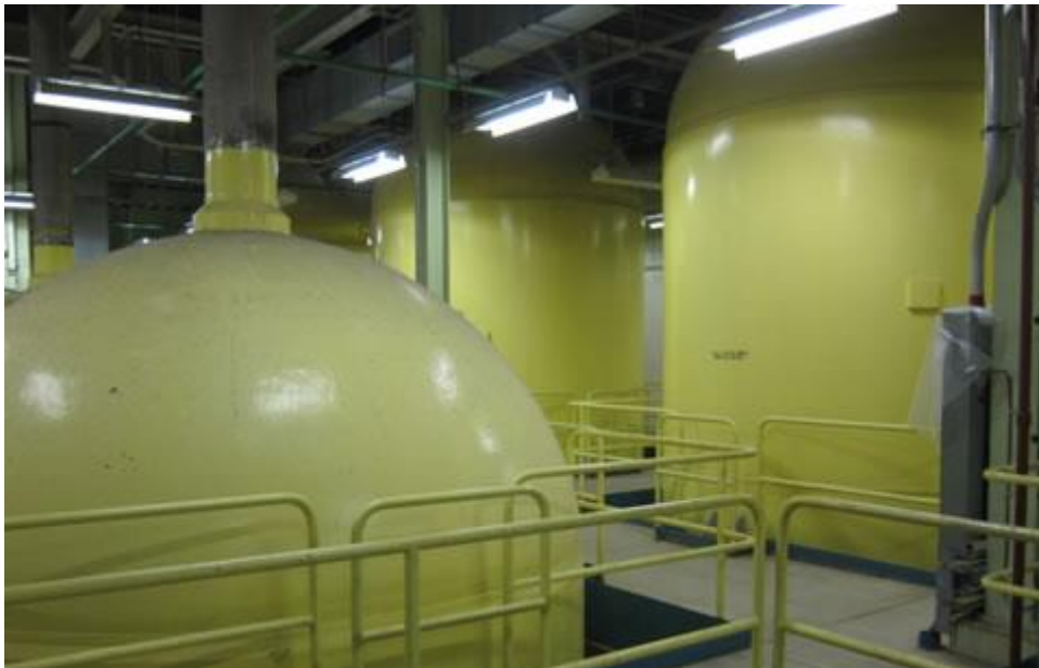
Slika 7. Spremnici dušika pod tlakom za hitne slučajeve [9]
