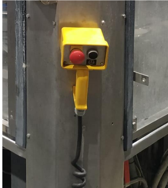
Slika 17. Mobilni upravljač stroja s prekidačem u slučaju nužde
