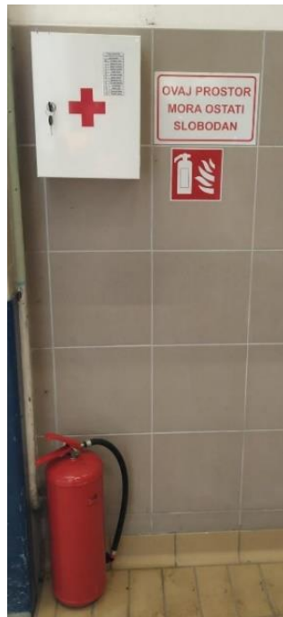
Slika 26. Ormarić sa kutijom prve pomoći i aparat za gašenje požara
