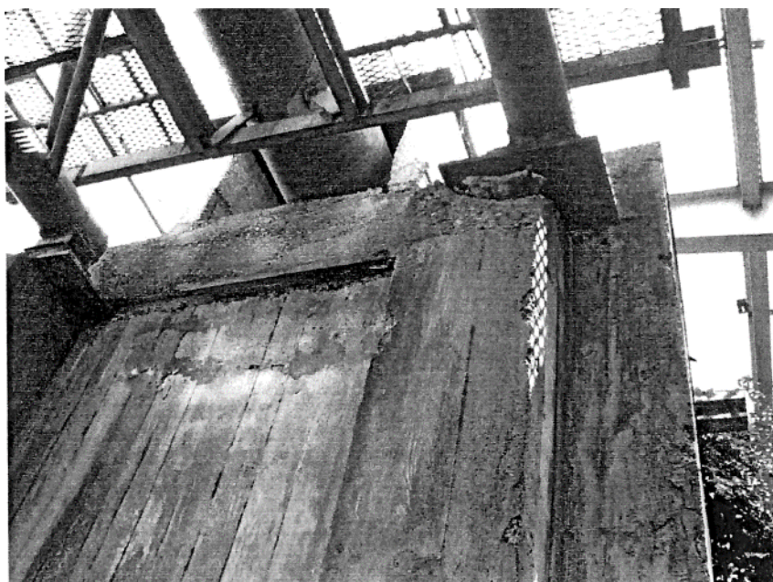
Slika 10. Oštećenja betonskih oslonaca noseće konstrukcije – Podsused
