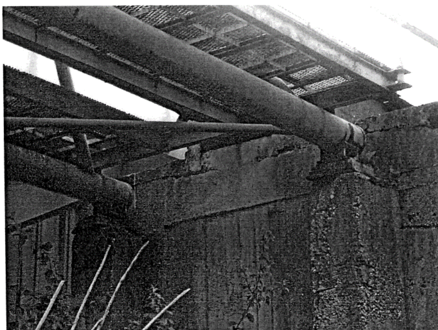
Slika 12. Oštećenje betonskih oslonaca noseće konstrukcije – Rakitje
