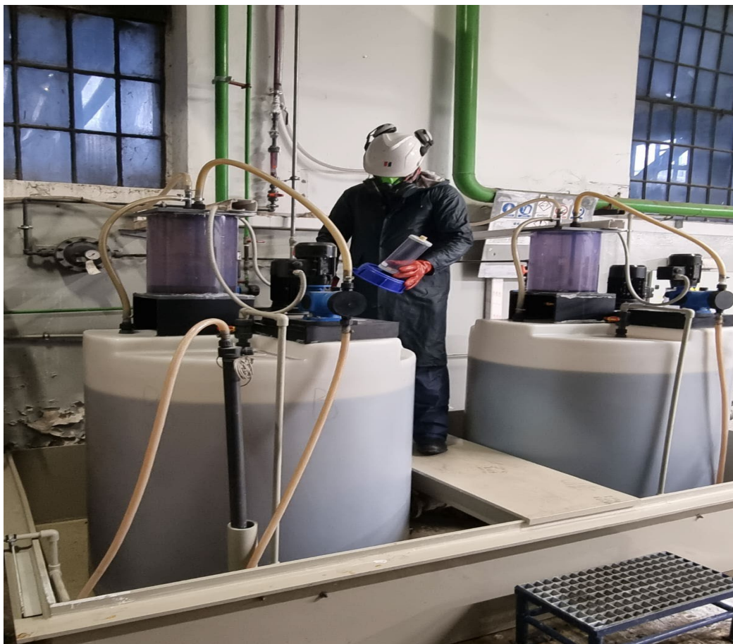
Slika 18. Dozirna stanica vrelovodnog sustava [24]
