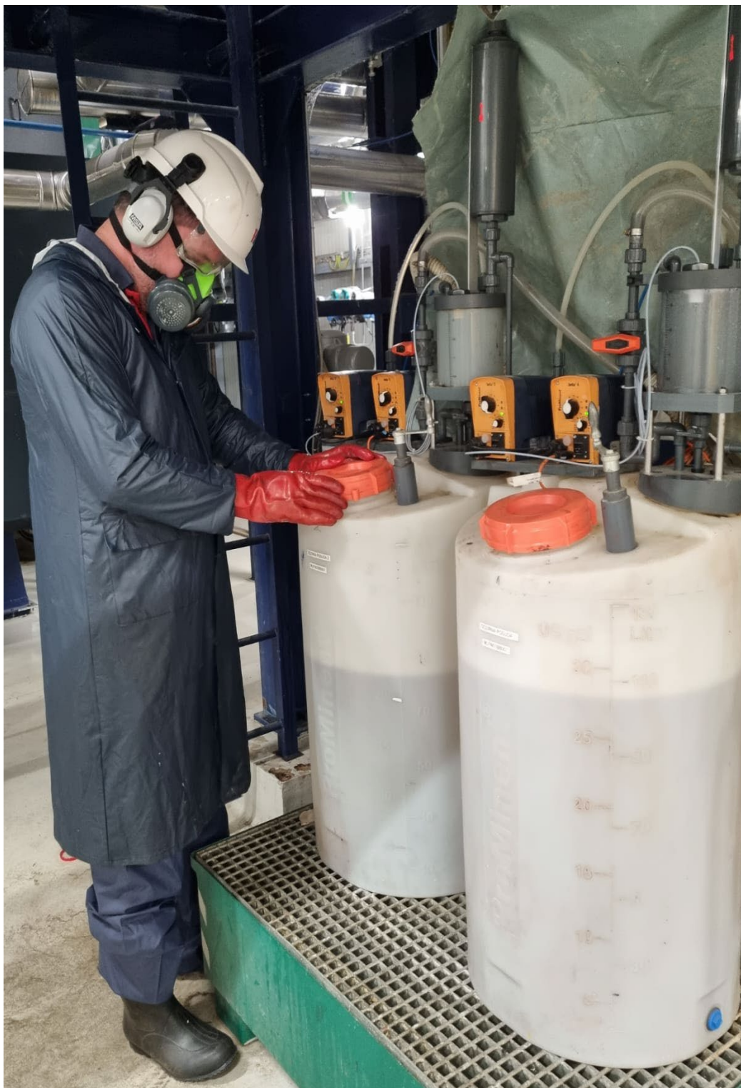
Slika 15. Dozirna stanica niskotlačnih kotlova NTK1 i NTK2 [22]
