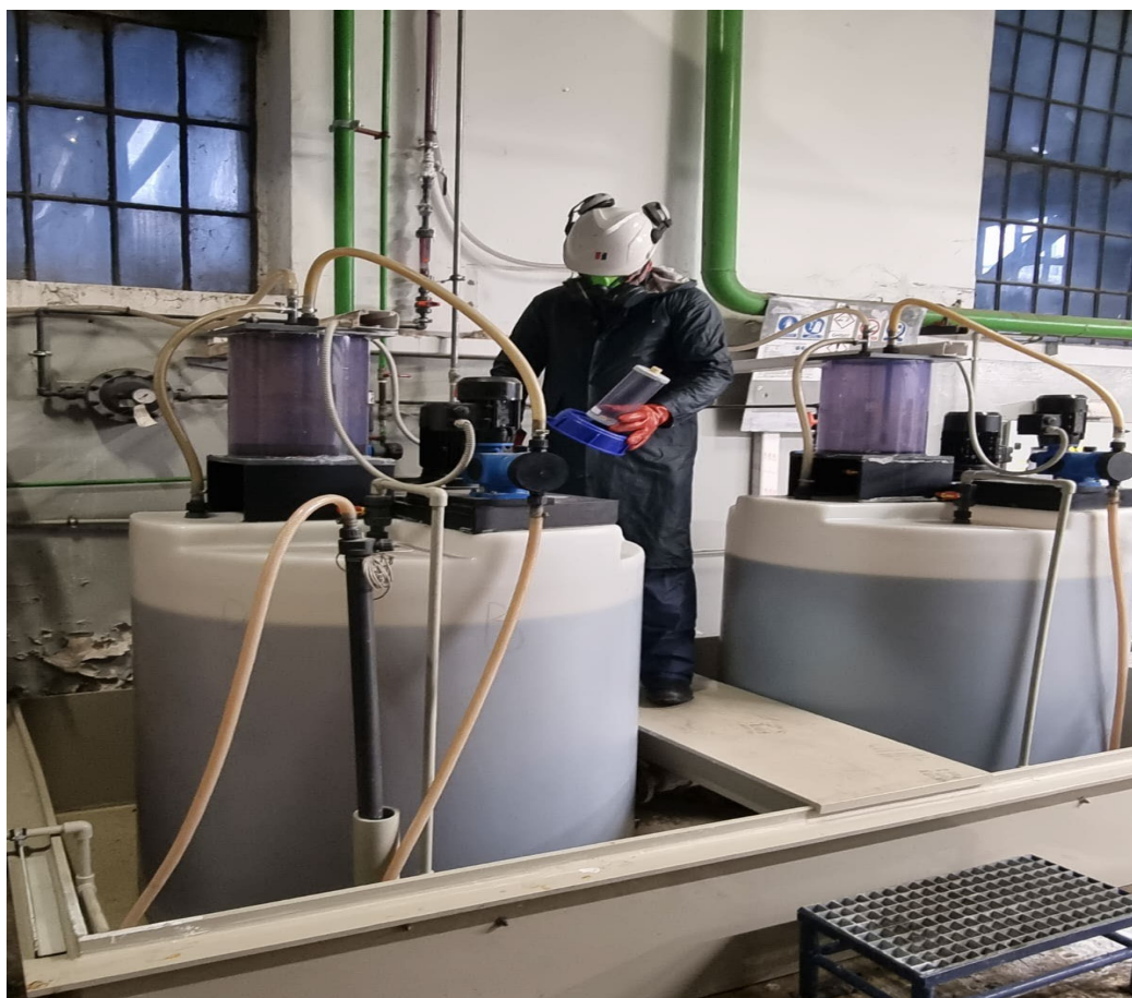
Slika 18. Dozirna stanica vrelovodnog sustava [24]
