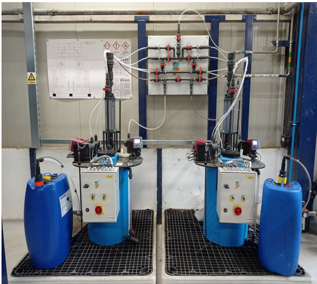
Slika 16. Dozirna stanica niskotlačnog kotla NTK3 [23]
