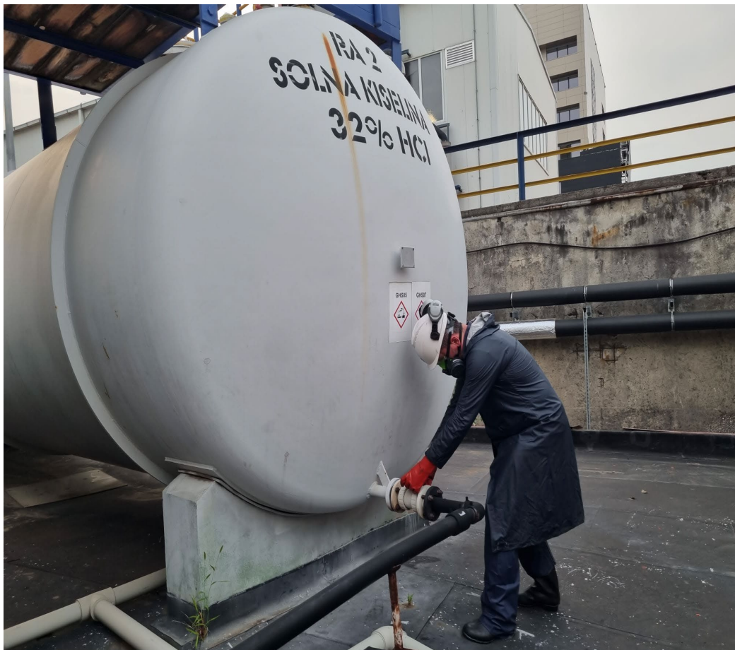
Slika 10. Zatvaranje ručnog ventila [16]
