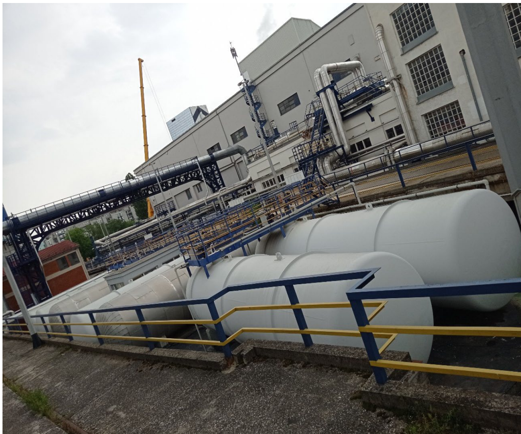
Slika 4. Spremnici solne kiseline i natrijevog hidroksida [8]
