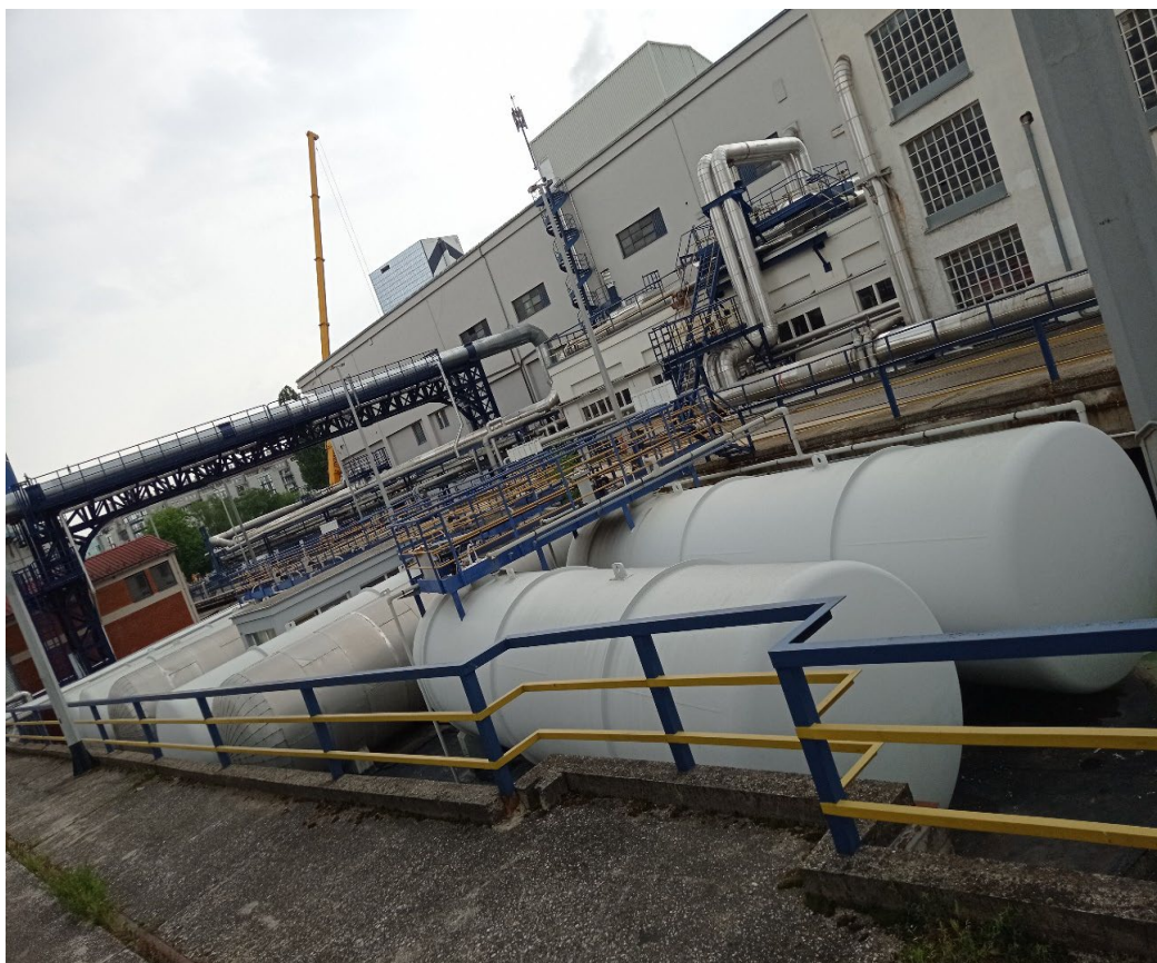
Slika 4. Spremnici solne kiseline i natrijevog hidroksida [8]
