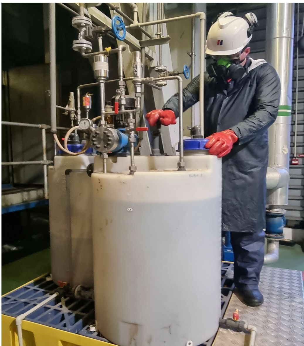
Slika 17. Dozirna stanica za kondicioniranje napojne vode plinske termoelektrane PTE1 i PTE2 [24]
