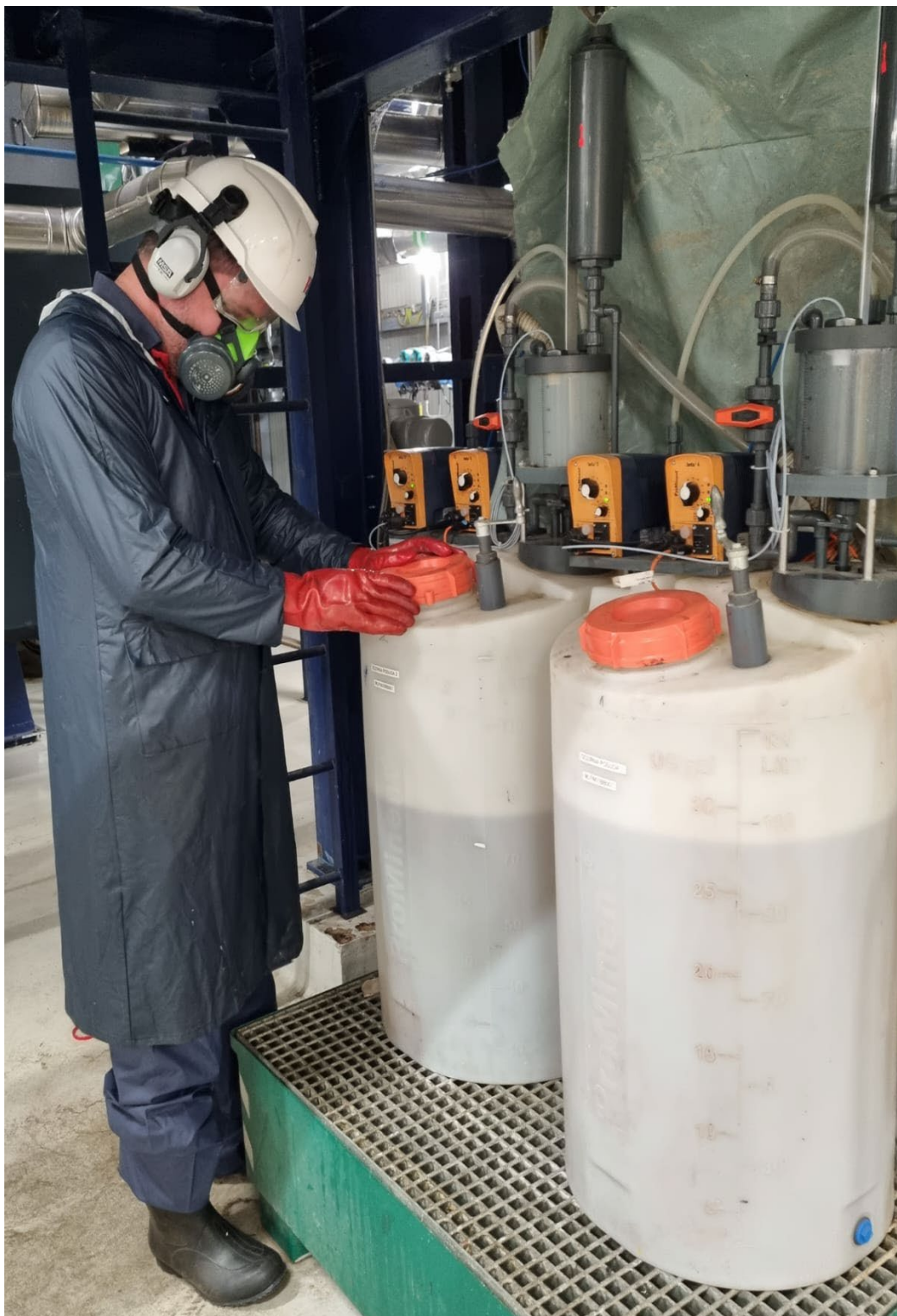
Slika 15. Dozirna stanica niskotlačnih kotlova NTK1 i NTK2 [22]
