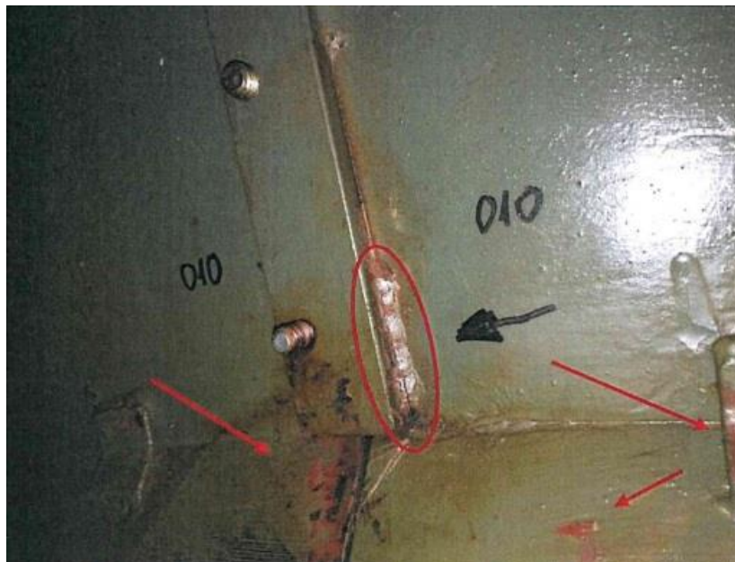
Slika 12: Segment gornjeg zaslona C10 - C10 registrirana pukotina i oštećenja AKZ
